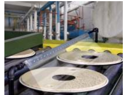
Una Súper Cortina seca tapas de tambores luego del proceso de lavado
